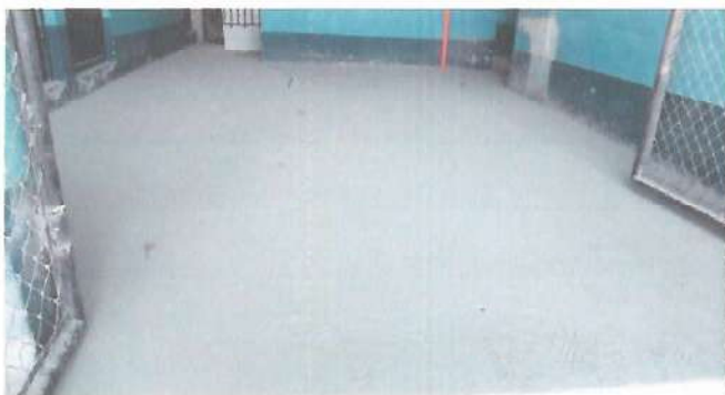
Foto 3: Piso ceramico o de granito en area del corredor del establecimiento.
